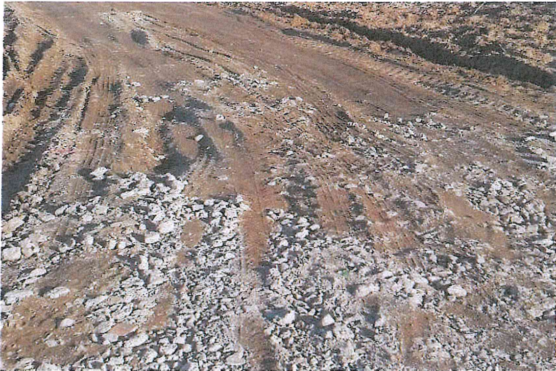
Foto nr1 . Wjazd w ulicę Kresowa od ulicy Kościelnej . Widoczny wciśnięty w grunt gruz betonowy . Tworzą się koleiny.
