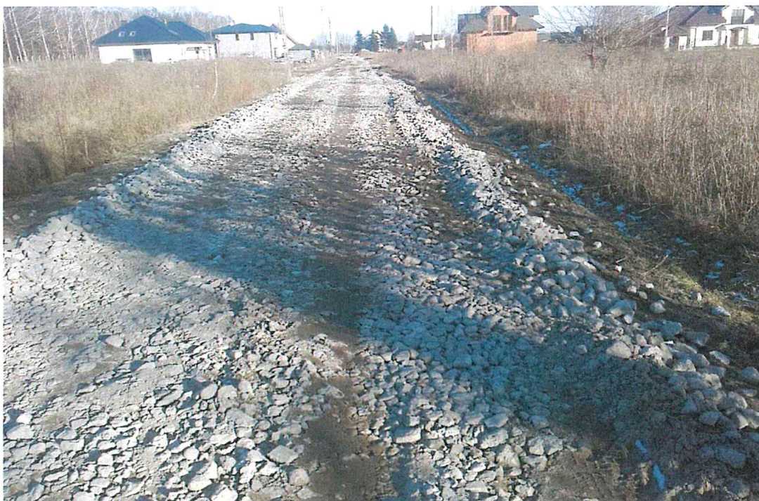
Foto nr2 . Ulica Brzozowa w kierunku ul. Polnej . Widoczny wciśnięty w grunt gruz betonowy . Tworzą się koleiny. Po bokach wypiętrzony gruz betonowy.
