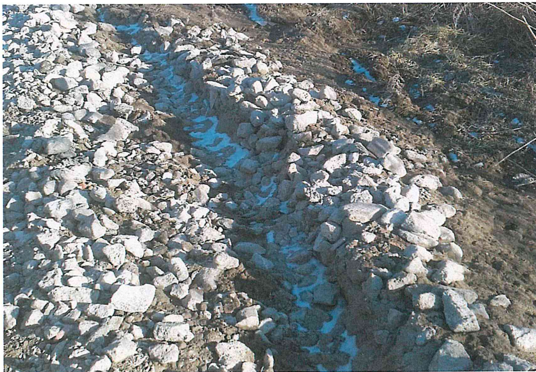
Foto nr 4 . Ulica Brzozowa cd. . Zbliżenie -widoczne zakończenie krawędzi drogi .
