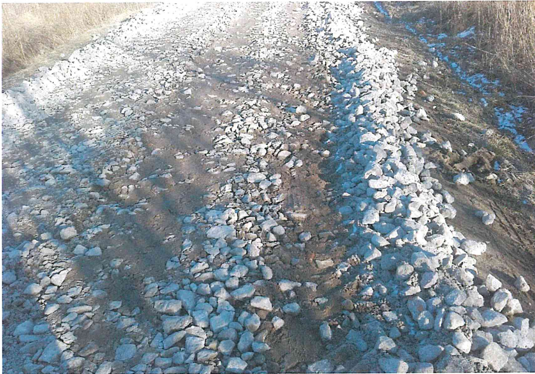
Foto nr 3 . Ulica Brzozowa w kierunku ul. Polnej . Widoczny wciśnięty w grunt gruz betonowy. Zbliżenie po bokach wypiętrzony gruz betonowy.
