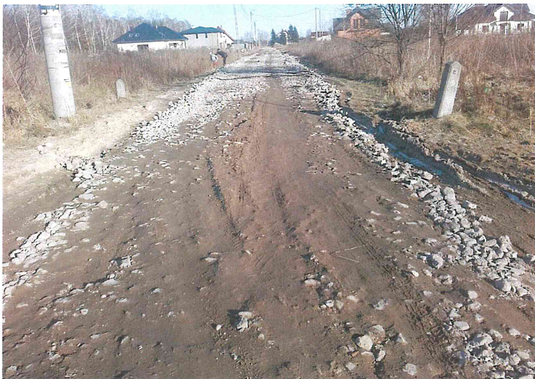
Foto nr1 . Wjazd w ulicę Brzozową od ulicy Radiowej. Widoczny wciśnięty w grunt gruz betonowy . Tworzą się koleiny.
