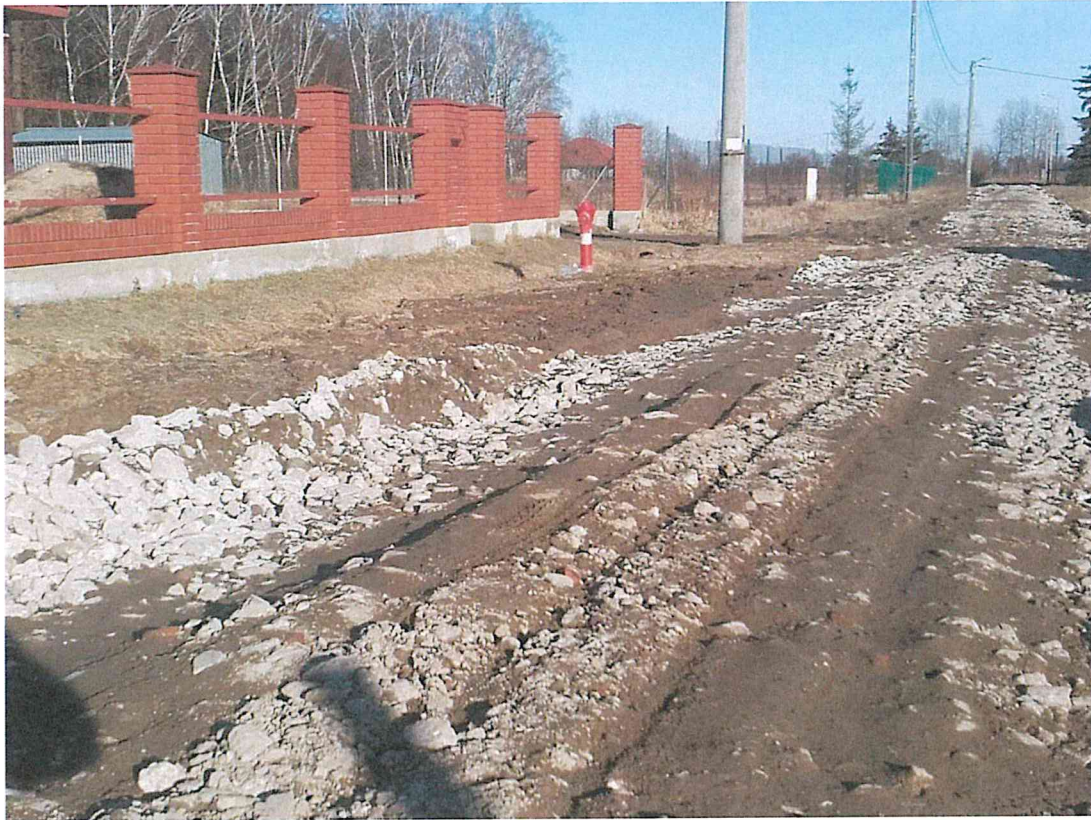
Foto nr 9. Ulica Brzozowa cd. Wypiętrzenie gruntu i gruzu środkowej części ulicy. Widoczne koleiny –ryzyko zaczepienia podwoziem samochodu osobowego.
